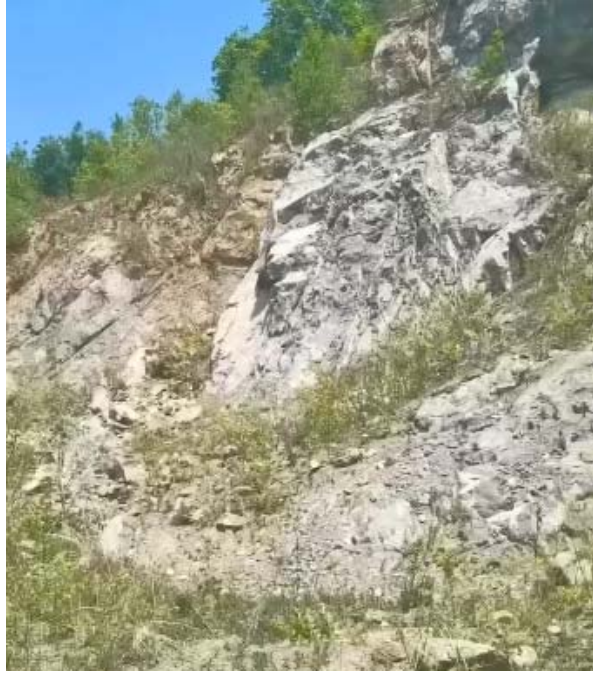
图 3-1 露天采坑崩塌
